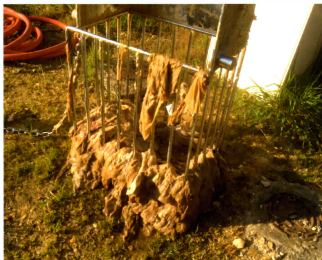
Accumulation de lingettes dans le réseau des eaux usées © Reims Métropole
